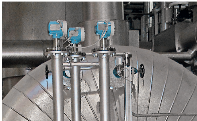
Контроль уровня в барабане парового котла при помощи направленных радаров Levelflex (архитектура резервирования «два-из-трех»)
